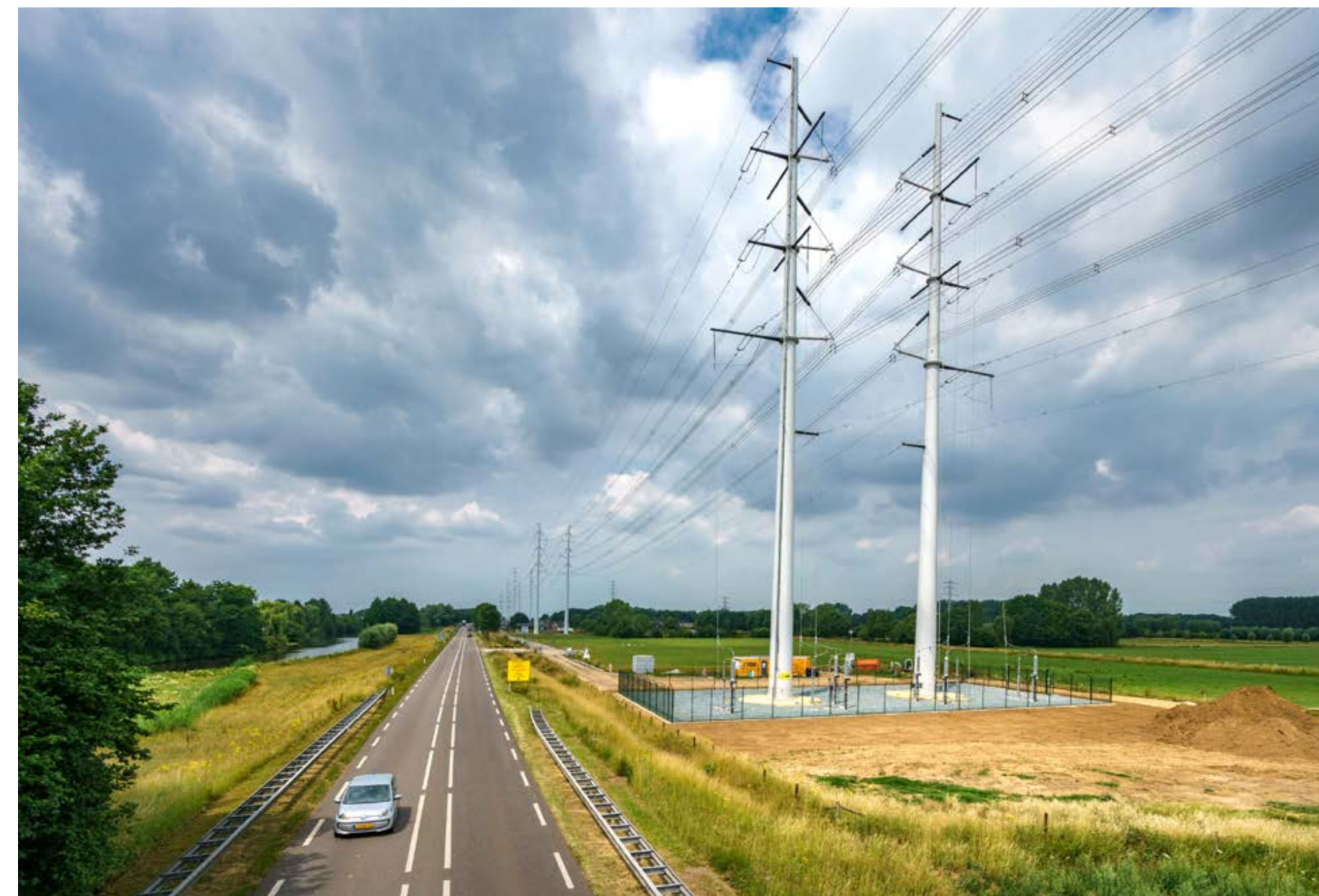
Een 150 kV afstappunt in een 380 kV Wintrack verbinding
