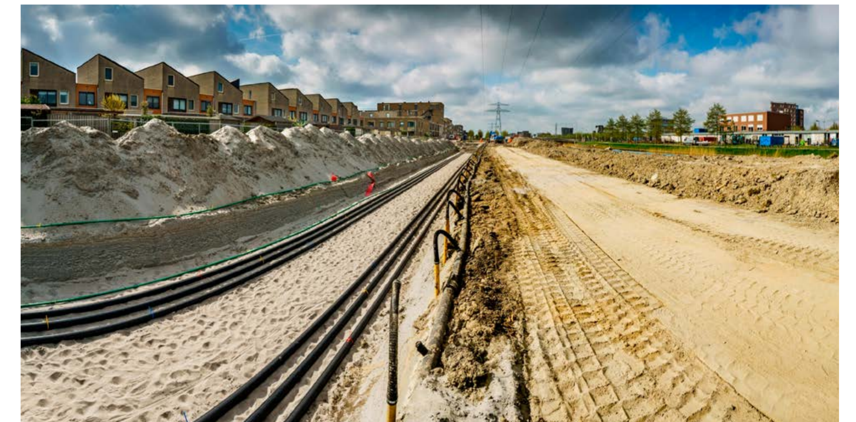
De kabelgoot tbv de aanleg van een ondergrondse 150 kV verbinding in open ontgraving
