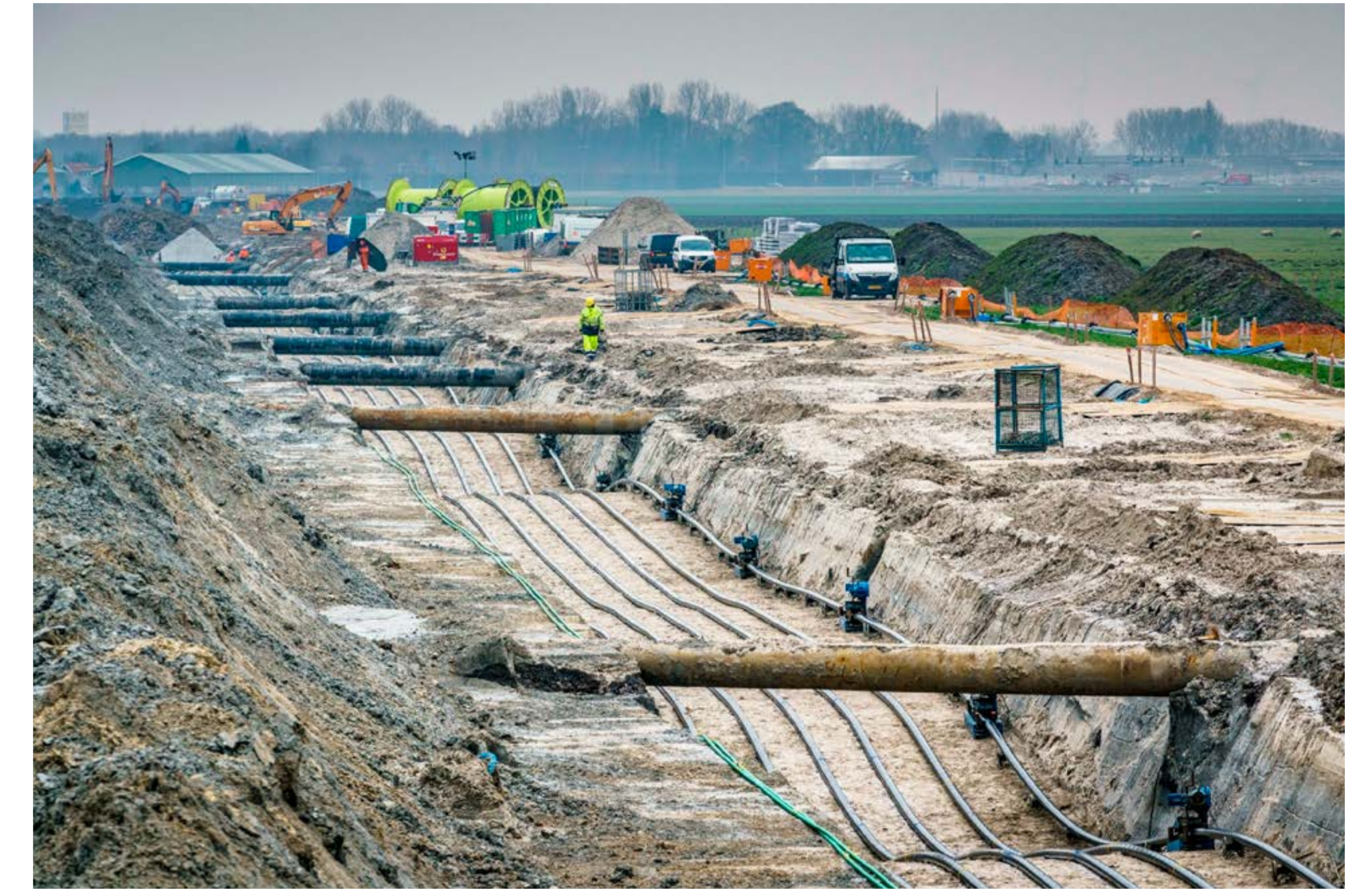
De kabelgoot tbv de aanleg van een ondergrondse 380 kV verbinding in open ontgraving
