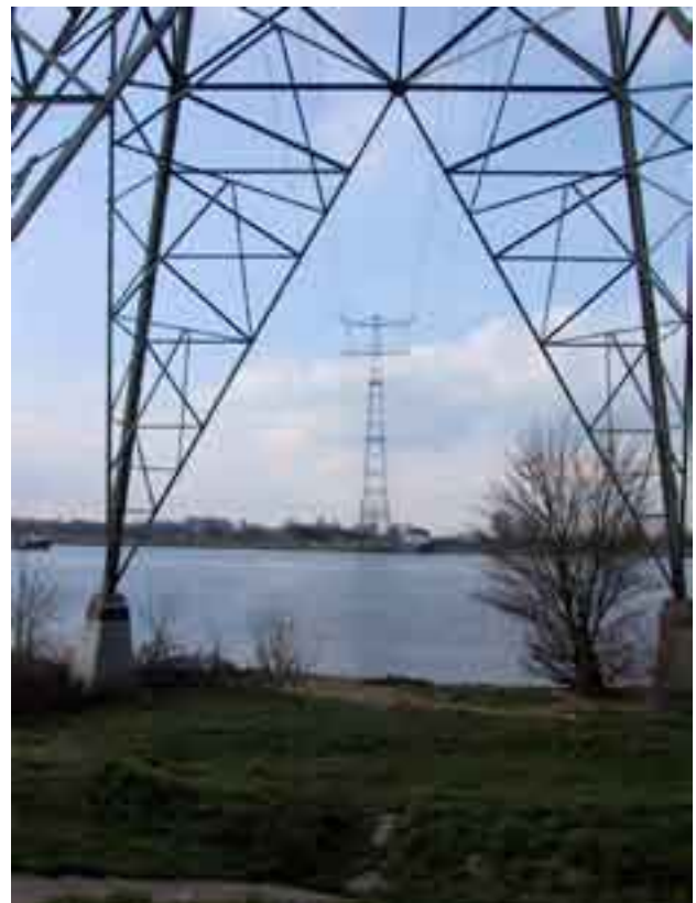
Hoogspanningsmasten bij de waterkruising met de Lek.
